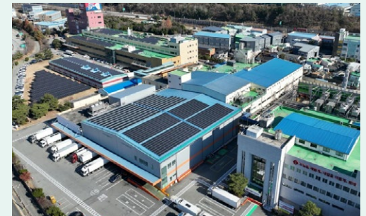
롯데웰푸드 양산공장에 설치된 태양광 발전설비
