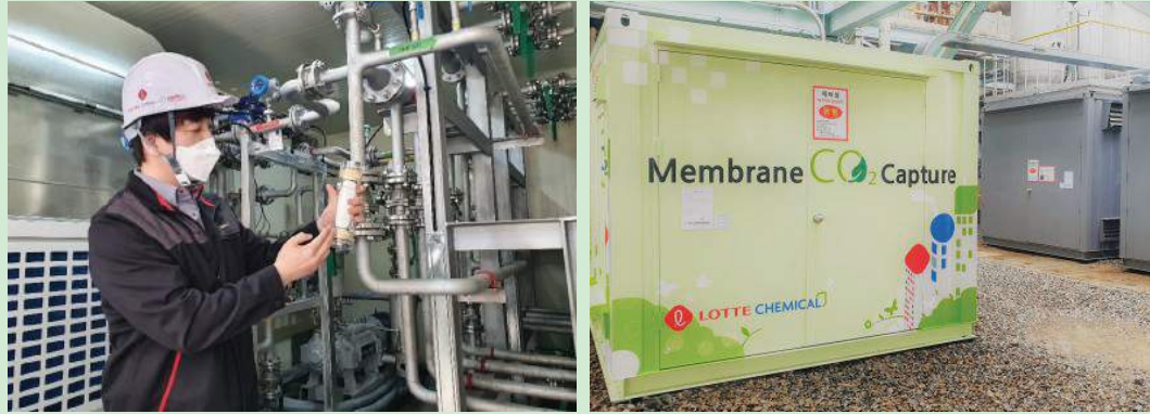
여수공장 내 이산화탄소 포집·활용(CCU) 실증설비
