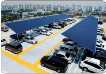
롯데마트 평택점 태양광 설비 시설
